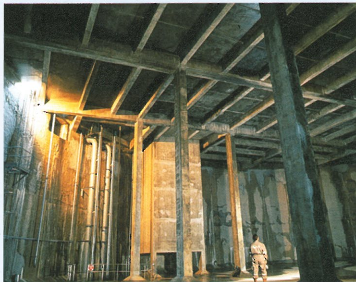
Les bassins de retenue d'eaux pluviales (ici celui de Bergonie, près de Bordeaux) pourront désormais être calibrés au plus juste.
